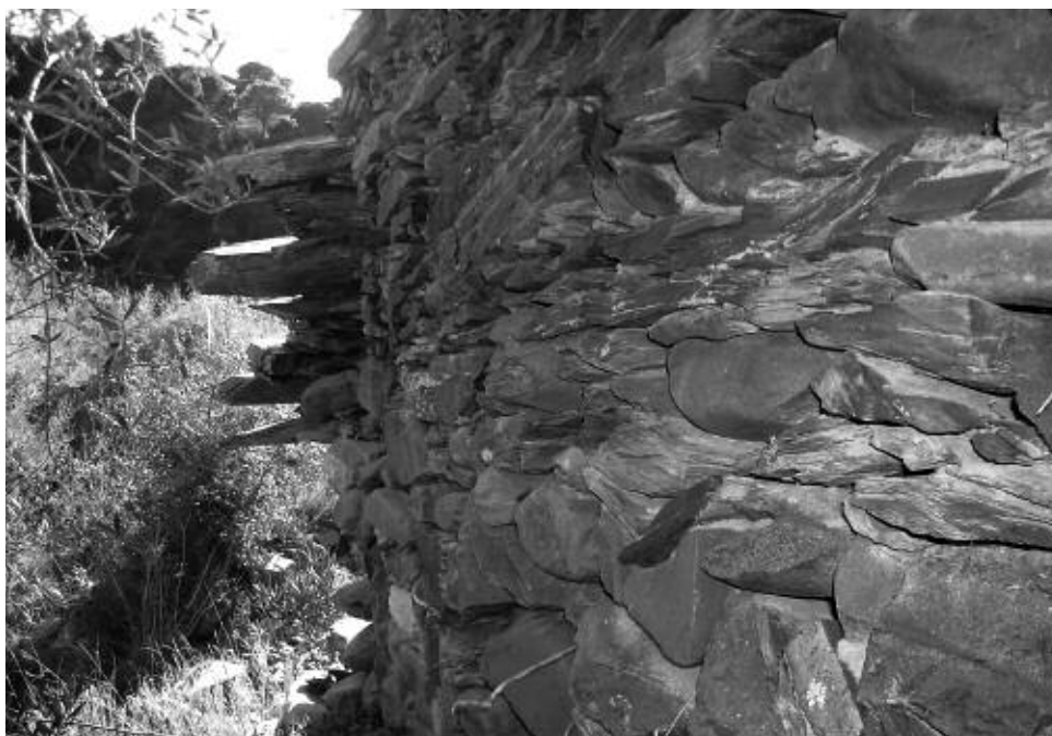
Figura 70 – Vista de la pared Oeste desde el interior de la Azenha da Martulheira . Entre los problemas presentes de urgente atención, está la pérdida de materiales blandos que servían de cementante, puesto que incrementa el riesgo de derrumbe.
