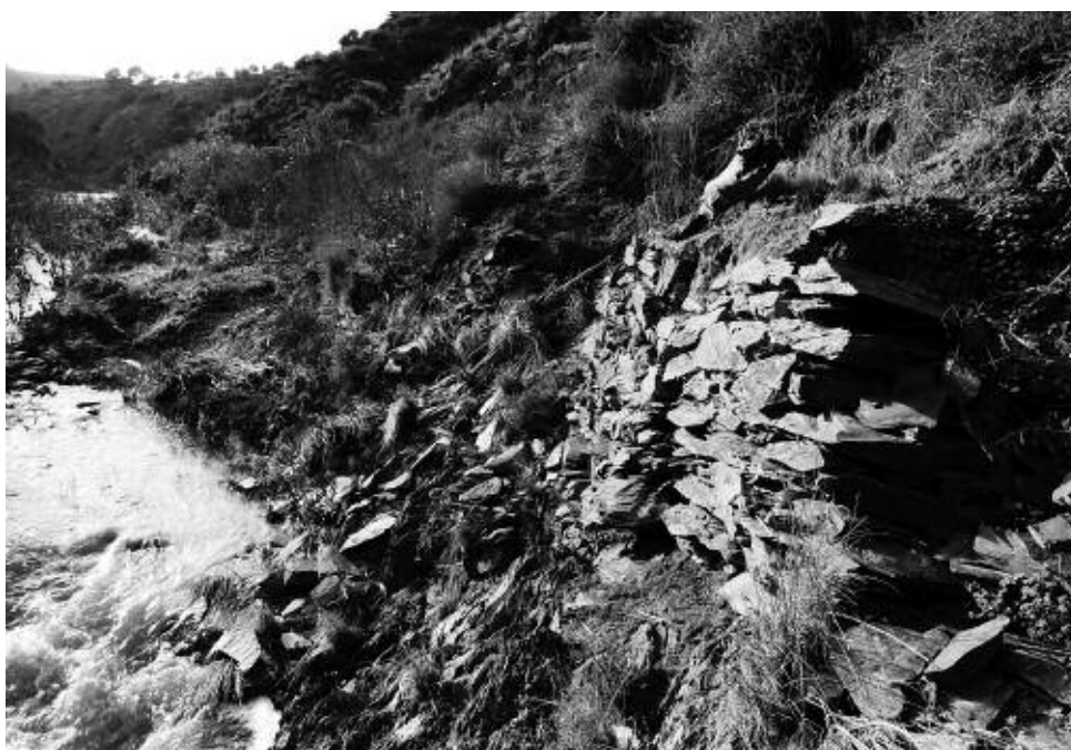
Figura 25 – La única evidencia de la vía entre la Barranca da Martulheira y la Azenha da Martulheira es esta sección mínima, aislada y descontextualizada. Este tramo estaba construido mediante una obra de piedra a manera de muro de contención, que en su mayor parte ha colapsado. En su momento, posibilitó la circulación de animales cargados, evitando los problemas ocasionados por riadas ( enchentes ), como la que se muestra en la imagen (fotografía tomada el 14 de enero de 2010).
