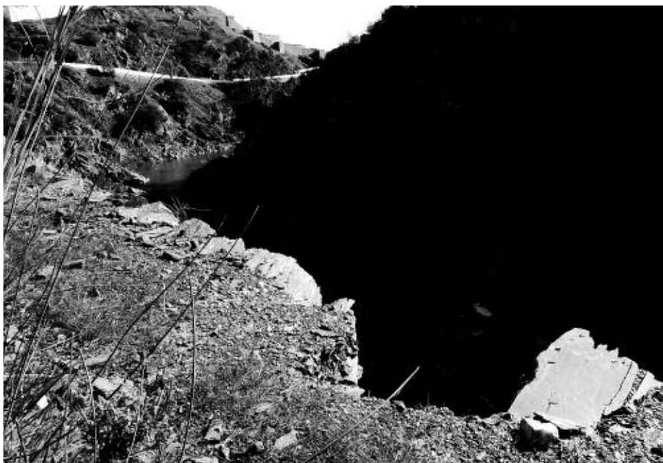
Figura 22 – Tramo de la vía de la Porta de Beja al Moinho das Bruxas donde se muestra el muro de contención que está derruyendo. Al fondo, la villa de Mértola.
