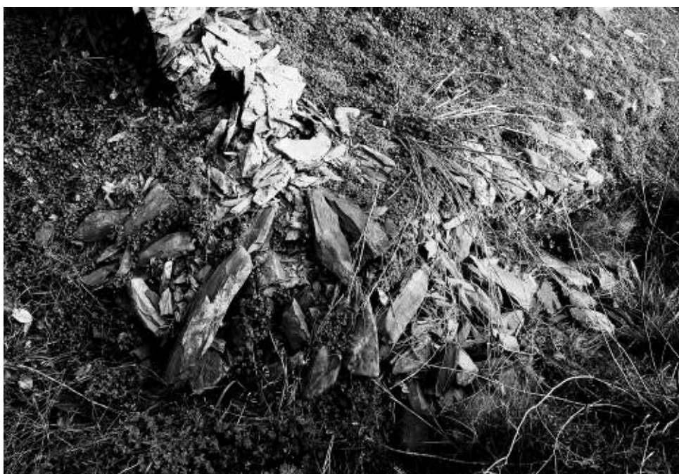
Figura 59 – Vista vertical de las piedras desprendidas de la pared Norte de la casa del molinero del Moinho da Fação . A efectos de la oxidación diferencial de la superficie de estas piedras, es posible registrar una especie de estratigrafía del proceso de caída.
