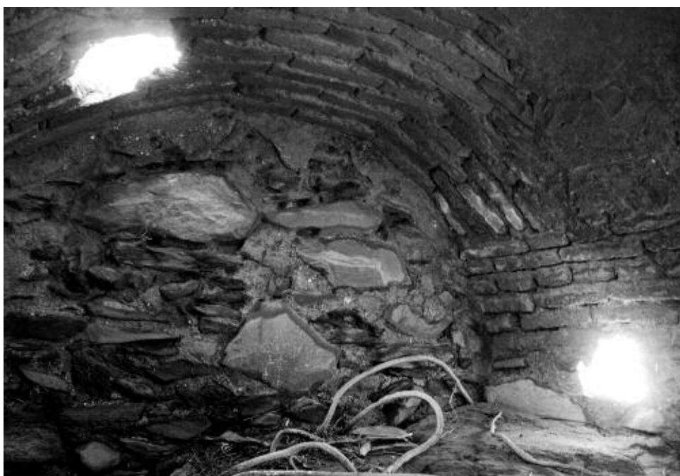
Figura 38 – Interior del Moinho das Bruxas . Resalta, a modo de tragaluz, el hueco causado por la caída de una sección de la bóveda. También, en primer plano, una maraña de raíces, factiblemente de la higuera ( Ficus carica ) que crece sobre la estructura.
