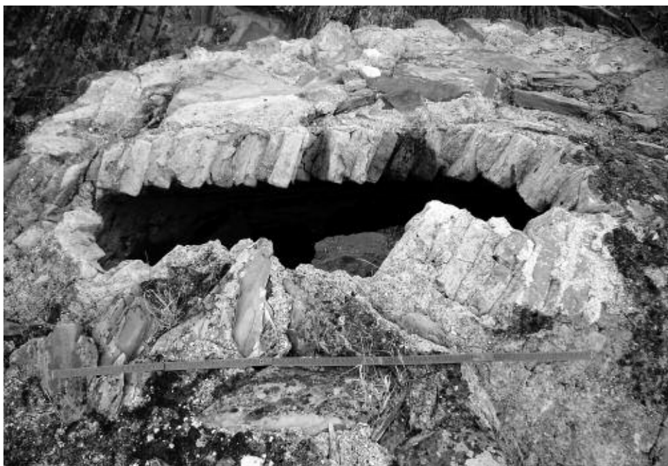
Figura 40 – Detalle de la parte exterior de la bóveda del Moinho das Bruxas , en la sección de los ladrillos ( tijolos ) caídos, con un metro plegable en primer plano.
