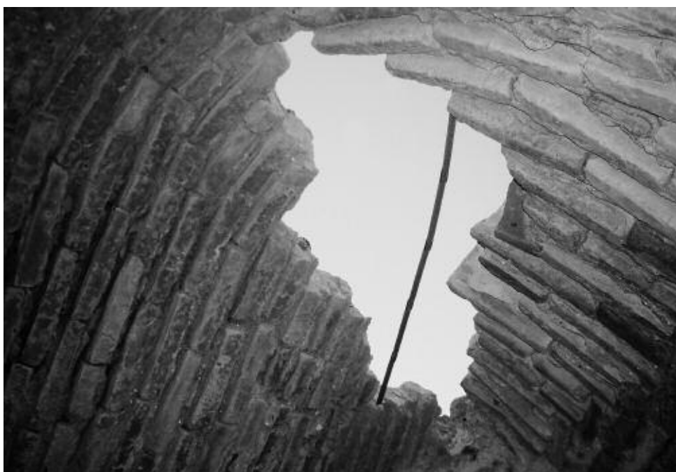
Figura 41 – Detalle de la parte interior de la bóveda del Moinho das Bruxas , sección de ladrillos ( tijolos ) caídos, con un metro plegable.
