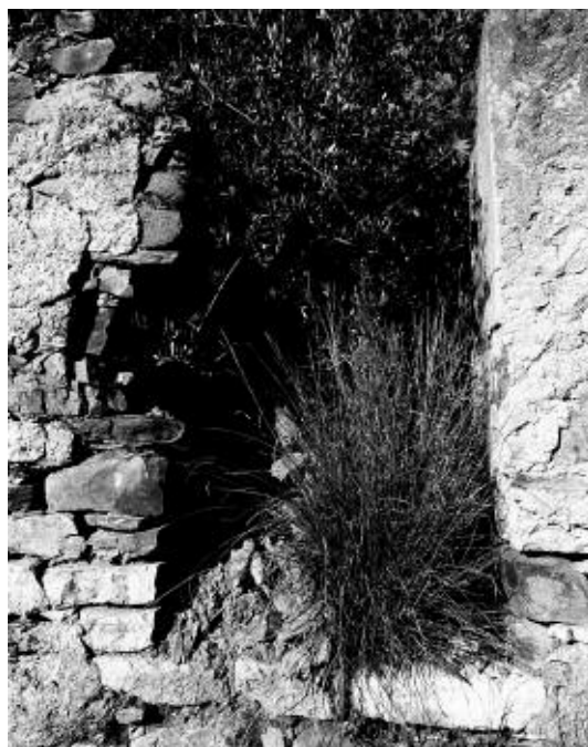
Figura 33 – Puerta de la casa de apoyo ( casa de apoio ) del Moinho das Bruxas , la jamba de la izquierda presenta dos áreas con piedras faltantes, situadas en las partes media y superior. También se observa el olivo silvestre ( Olea europaea var. sylvestris ) que crece en su interior obstruyendo el paso.
