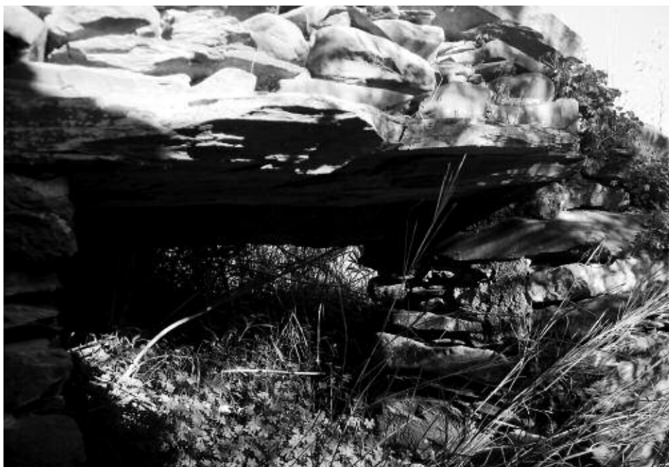
Figura 68 – La pared Este, donde está la puerta de acceso a la Azenha da Martulheira , muestra un proceso avanzado de derrumbamiento.
