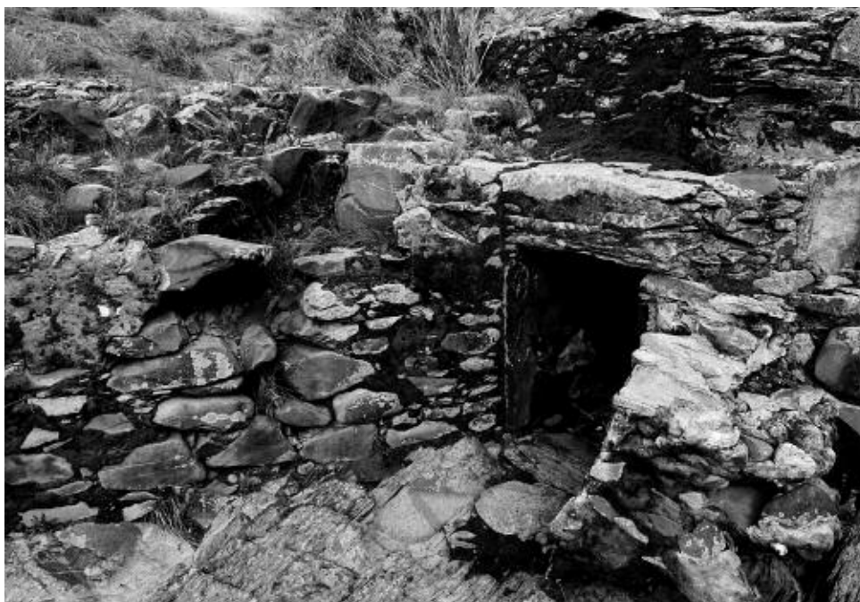
Figura 48 – La pared izquierda del canal ( levada ) del Moinho das Bruxas presenta un proceso inicial de caída de piedras que es necesario atender, antes de que alcance un estado crítico y urgente. También se reconocen los restos de la pared derecha.
