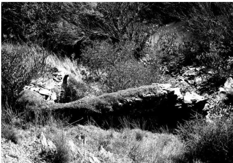
Figura 67 – La fábrica de la Azenha da Martulheira conserva en pie las paredes Norte y Oeste, que dan a la ladera; por otra parte, la pared Este, donde está situada la puerta de acceso, está colapsando; y la pared Sur, que da al arroyo, donde era montaba la rueda y el eje que hacían funcionar el mecanismo molinero, ha caído totalmente. En su interior crece un olivo silvestre ( Olea europaea var. sylvestris ).
