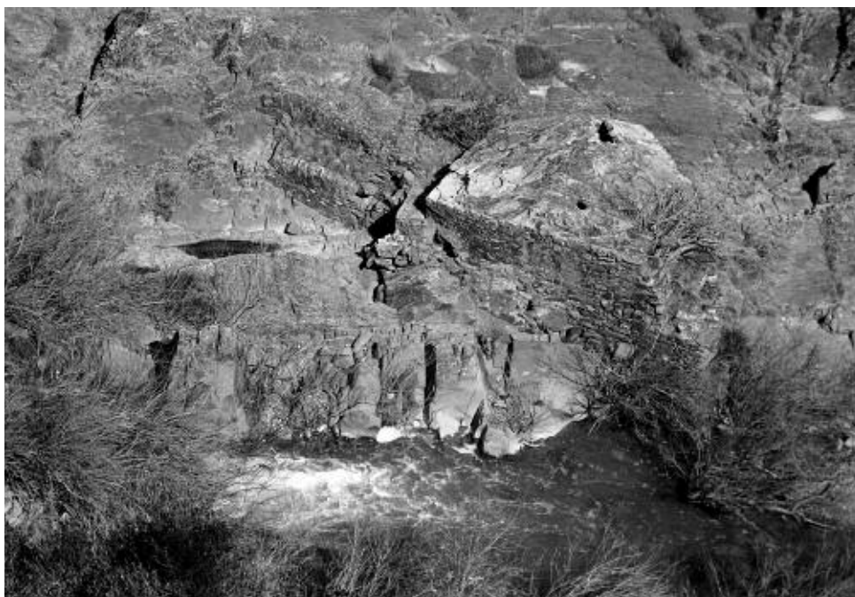
Figura 36 – Vista del Moinho das Bruxas del lado que da al arroyo. En la parte superior de la bóveda se aprecia el hueco provocado por la caída de una sección de ladrillos ( tijolos ).
