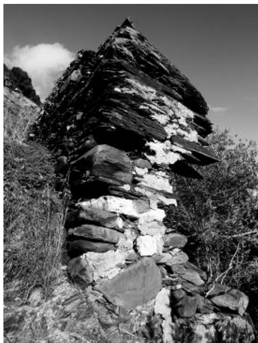
Figura 71 – Detalle de la pared Oeste de la Azenha da Martulheira , que se encuentra en una situación de inestabilidad estructural, ocasionada por el derrumbamiento de la pared Sur. Su consolidación es de urgencia crítica.
