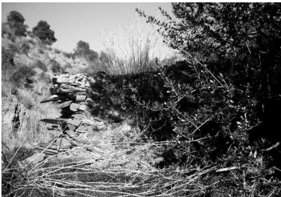
Figura 56 – Una parte de la pared Norte de la casa del molinero del Moinho da Fação , que aún está en pie, presenta un proceso avanzado de derrumbamiento (fotografía del 19 de noviembre de 2008; original en color).
