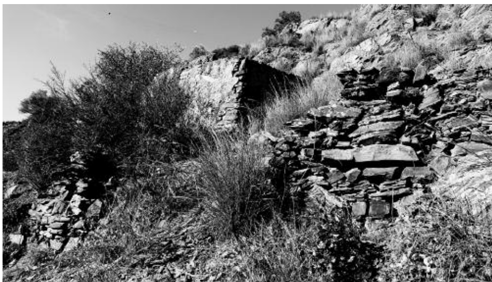
Figura 24 – Tramo de la vía al Moinho das Bruxas frente a la casa del molinero. Aquí, el muro de contención, a efecto de las rocas que han derruido, muestra un enorme boquete. Un problema que incrementa este proceso de destrucción es el arbusto cuyas raíces remueven los elementos constructivos.
