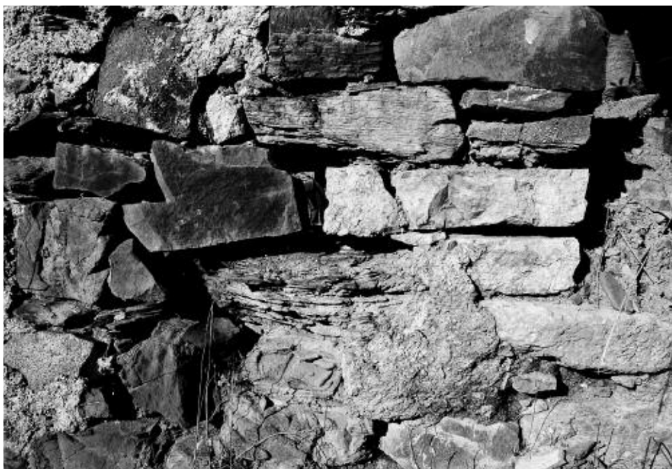
Figura 35 – La pérdida del enjarrado del paramento exterior y la erosión de la argamasa cementante que da cohesión a las piedras, es particularmente preocupante en el área inferior de la jamba izquierda de la casa de apoyo ( casa de apoio ), del Moinho das Bruxas .
