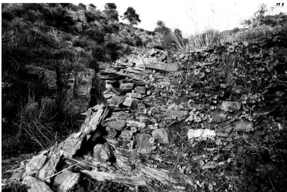
Figura 57 – Una parte de la pared Norte de la casa del molinero del Moinho da Fação , que en la fotografía anterior se mostraba en pie, ya colapsó. El efecto crítico de las lluvias del invierno de 2009-2010 se observa en el reblandecimiento y la remoción de los materiales cementantes, problema que acelera el proceso de derrumbe (fotografía del 2 de febrero de 2010).
