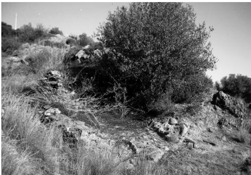
Figura 55 – Un olivo silvestre ( Olea europaea var. sylvestris ; en portugués, zambujeiro) crece en el interior de la casa del molinero del Moinho da Fação. El estado avanzado de destrucción de esta construcción resulta de suma gravedad.
