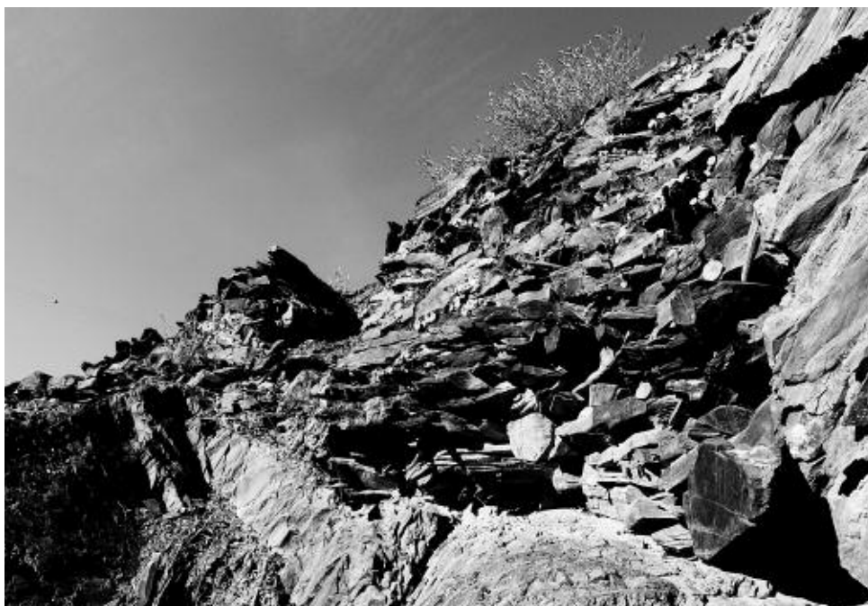
Figura 23 – Otra vista del tramo anterior, donde se muestra que el muro de contención perdió la argamasa que fija las piedras, por lo que sólo parecieran estar superpuestas con el peligro de inestabilidad que eso crea. Asimismo, es notoria la parte que está a derruir.
