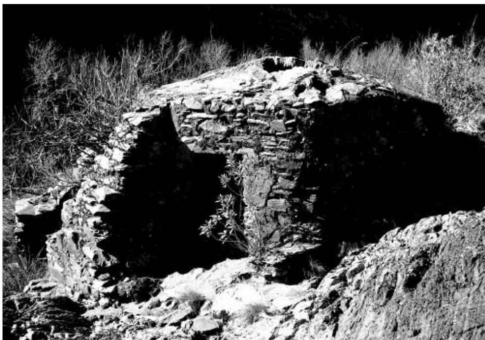
Figura 37 – Vista de la entrada al Moinho das Bruxas . Se aprecia el hueco en la bóveda provocado por la caída de una sección de ladrillos ( tijolos ).
