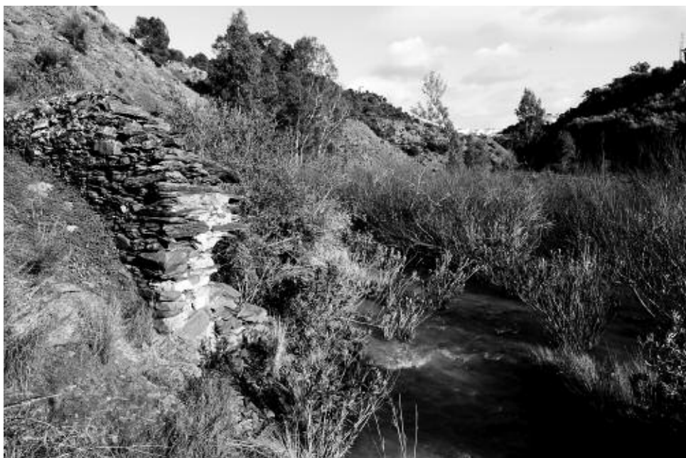
Figura 69 – La pared Oeste de la Azenha da Martulheira precisa de ser consolidada porque, al caer la pared Sur, que daba al arroyo, quedó en una situación de inestabilidad estructural. El riesgo de colapso se incrementa en inviernos lluviosos, por el reblandecimiento de materiales y por la fuerza de las riadas ( cheias ). También se observa un olivo silvestre ( Olea europaea var. sylvestris ) y tamariz ( tamarix sp.).
