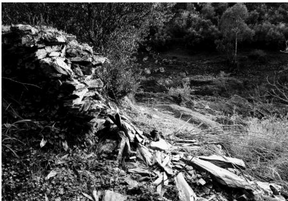
Figura 58 – Otravista de las piedras desprendidas de la pared Norte de la casa del molinero del Moinho da Fação .
