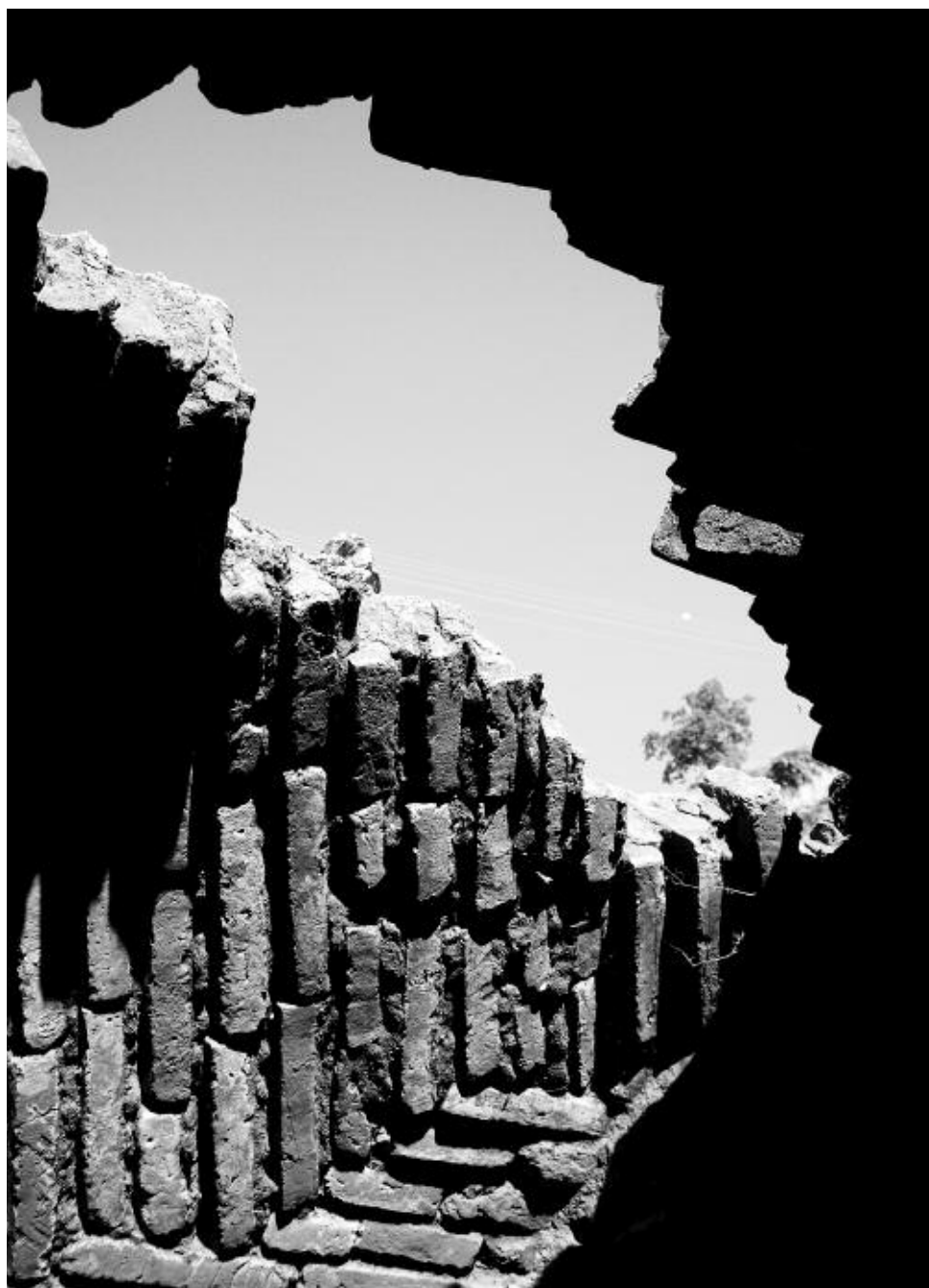
Figura 39 – Vista desde el interior de la bóveda del Moinho das Bruxas , donde se muestra un detalle de la obra de ensamblado de ladrillos ( tijolos ), que sostiene la techumbre; y las piezas caídas, que forman una oquedad. El deterioro estructural es de suma gravedad, porque pone en peligro la conservación del molino.
